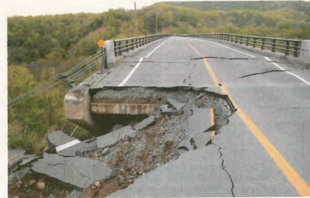
写真4 ■ 2000年に竣工した3径間連続の俵山大橋。橋台部の周辺地盤が崩壊して、基礎が露出。橋台には縦方向のひび割れが入っていた
