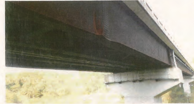
写真6 ■ 俵山大橋の中間橋脚部付近。主桁下部が座屈していた(写真:池田隆明・長岡技術科学大学教授)
