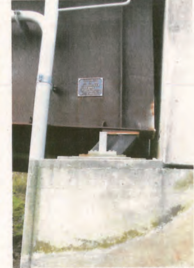
写真5 ■ 俵山大橋は設計に1996年の道路橋示方書を適用。積層ゴム支承が大きく変形して、桁端部が橋台に衝突していた
